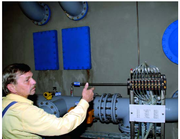
> Kontrolle der Wasseraufbereitung: Maschinist Claus Schober weiß, dass das Lebensmittel Trinkwasser jede Sorgfalt verdient.
