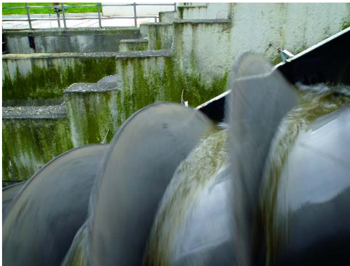
> Gewaltige Wasserschrauben heben das Abwasser in einem der ersten Schritte des Kärungsprozesses in die Vorklärbecken.
